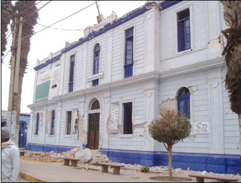
Foto 3 Frontis del Hospital San Juan de Dios despues del terremoto
