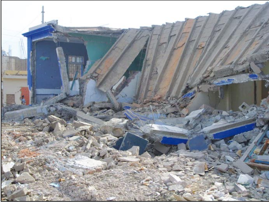
Foto 5-6 Colapso total zona de servicios generales
